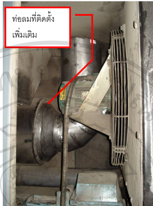
รูปผนวกที่ 12 ลักษณะการต่อท่อลมเพื่อดึงอากาศที่เย็นกว่าเข้าเครื่องอัดอากาศ
