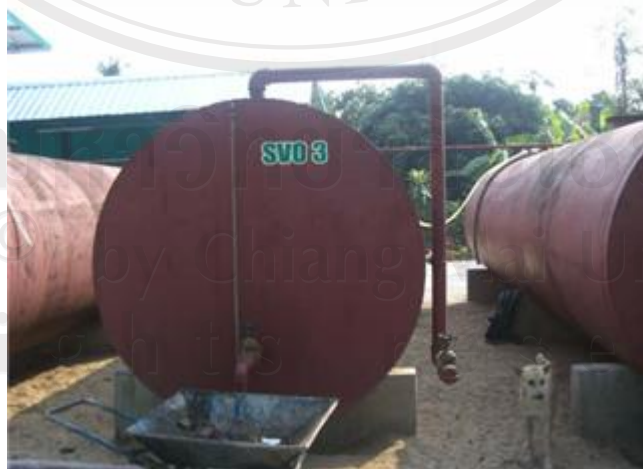
ภาพที่ 4.9 ถังแยกตะกอน
