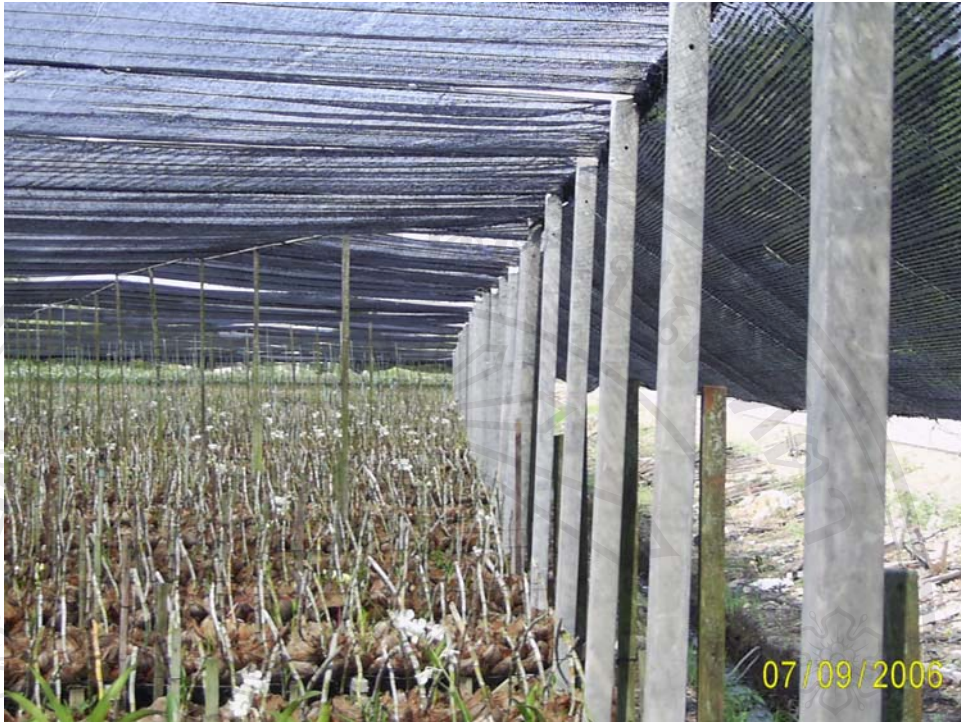
ภาพที่ 1 เสาโรงเรือนทำด้วยคอนกรีตขนาด 3x3 นิ้ว
