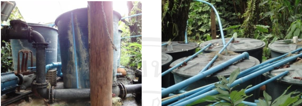
ภาพที่ 22 แสดงถังเก็บน้ำ
