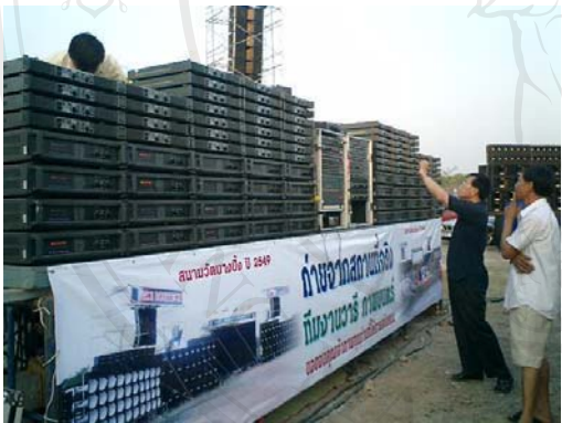
ภาพการติดตั้ง Power Amp
