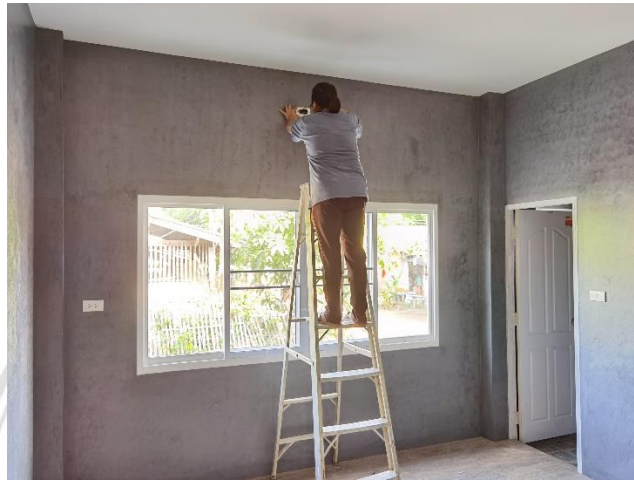
ภาพที่ 4.23 งานติดตั้งปลั๊ก สวิตซ์และโคมไฟ
