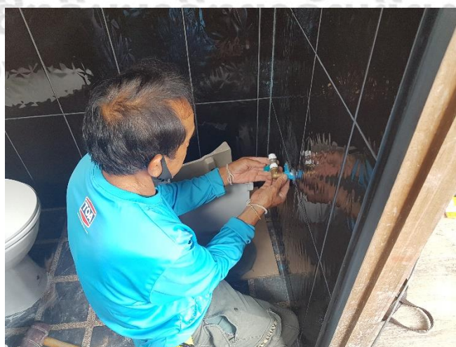
ภาพที่ 4.24 งานติดตั้งวัสดุอุปกรณ์ สุขภัณฑ์ในห้องน้ำ
