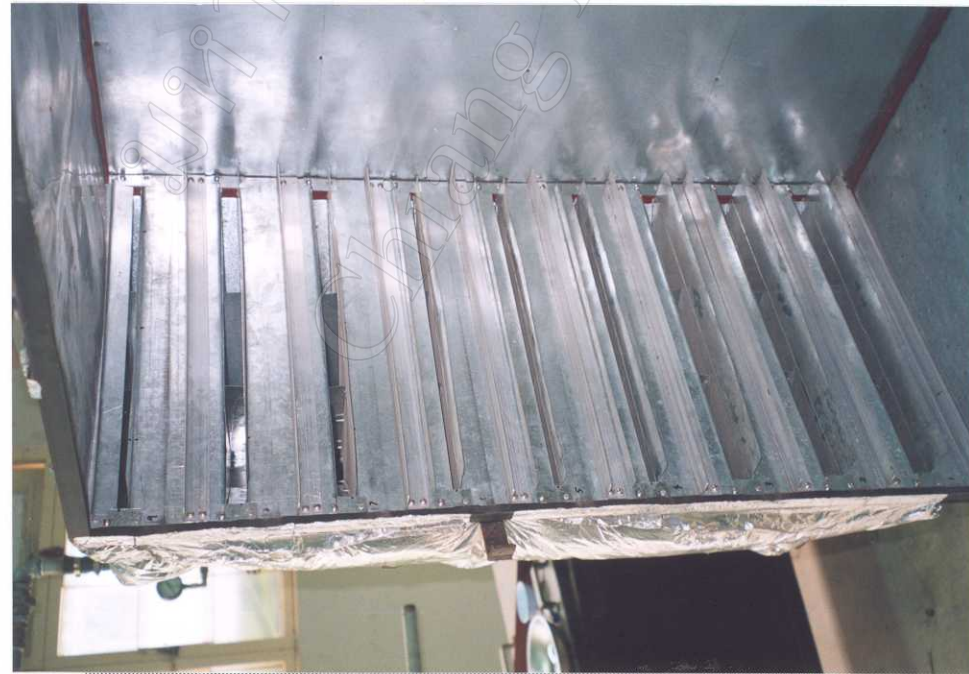
รูปผนวกที่ 5 ชั้นวางถาดและท่อกระจายอากาศร้อน
