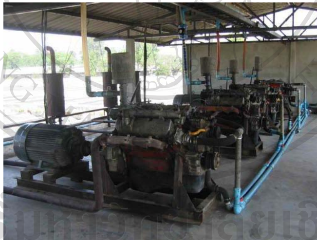
รูปที่ 4.6 แสดงภาพเครื่องกำเนิดไฟฟ้าด้วยก๊าซชีวภาพขนาด 110 kW
