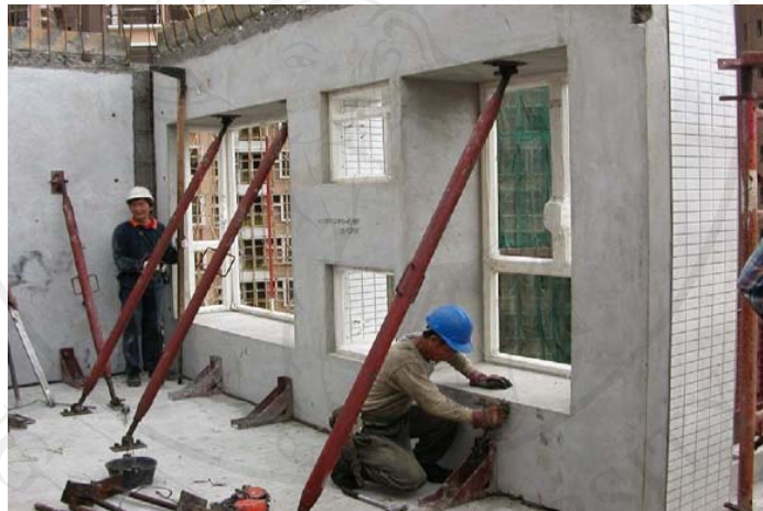
ภาพที่ 2.12 แสดงงานติดตั้งระบบขึ้นส่วนสำเร็จรูประบบแผ่น ที่มา : Precast Concrete Construction ONE CENTRAL, MACAU 2006
