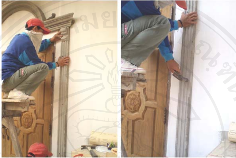
ภาพ 3.26 การติดตั้งบัว และการตอกเหล็กเข้าไปตามตำแหน่งที่เจาะไว้
