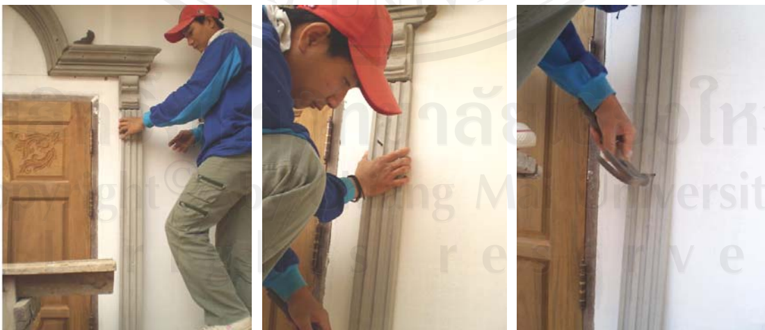
ภาพ 3.23 การทาบบัวกับผนัง การใส่เหล็ก และการตอกเพื่อสร้างตำแหน่งการเจาะผนัง
