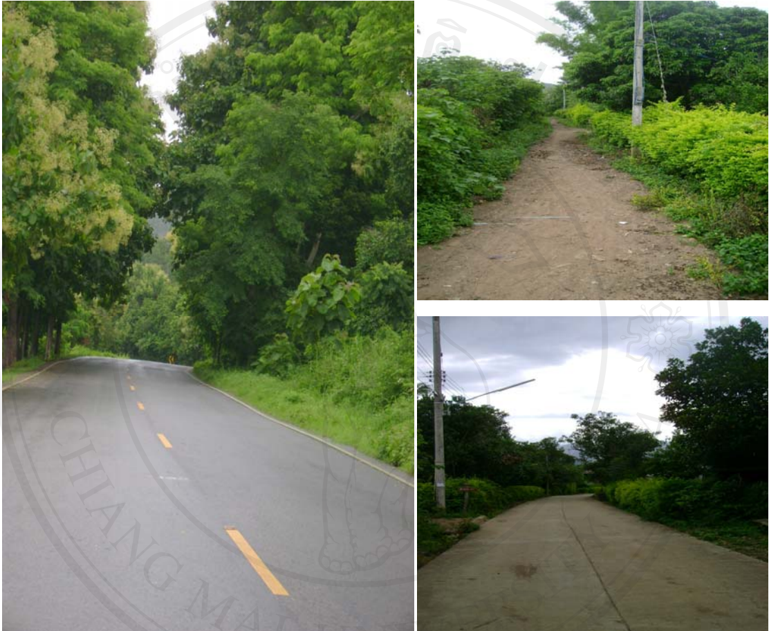
รูปภาพที่ 6 สภาพถนนหมายเลข 1095 และถนนภายในหมู่บ้าน
