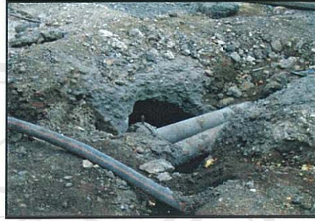
ภาพที่ 26 เศษหินดินทรายที่อุดตันท่อระบายน้ำ
