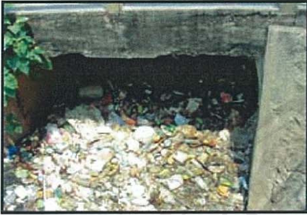
ภาพที่ 25 เศษขยะอุดตันทางระบายน้ำ
