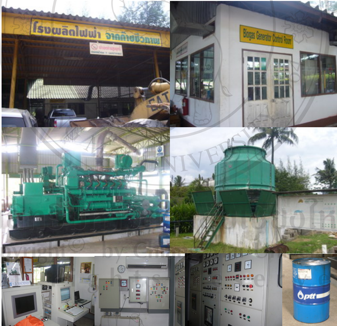
รูปที่ 4.5 แสดงเครื่องกำเนิดไฟฟ้า อุปกรณ์ควบคุม และระบบระบายความร้อน
