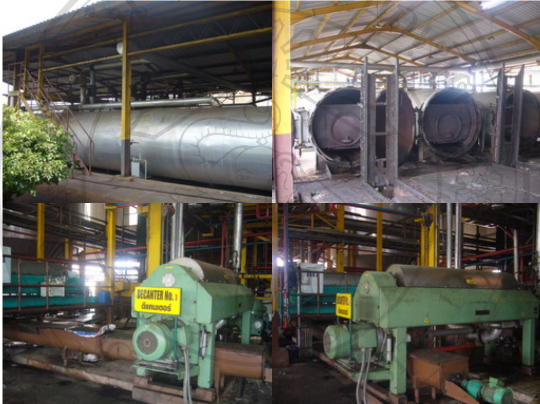
รูปที่ 4.2 แสดงหม้อไอน้ำที่ละลายด้วยไอน้ำและเครื่องแยกน้ำมัน
