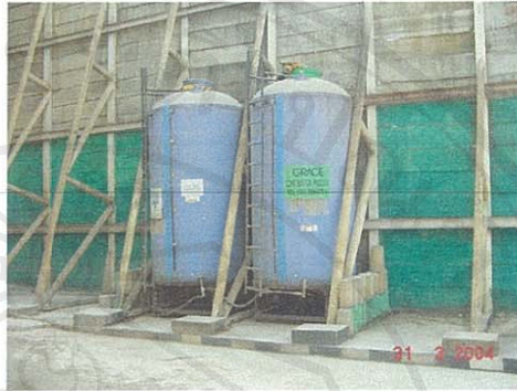
การจัดเก็บน้ำยาผสมคอนกรีต
