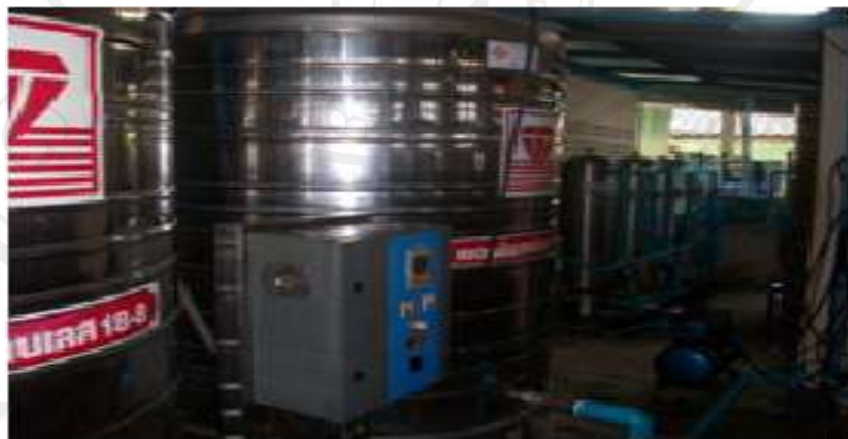
ภาพที่ 4 แสดงถังพักน้ำหลังกรอง
