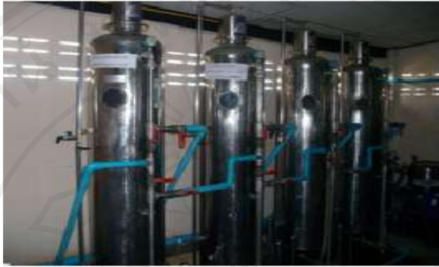
ภาพที่ 1 แสดงเครื่องกรองน้ำดิบ
