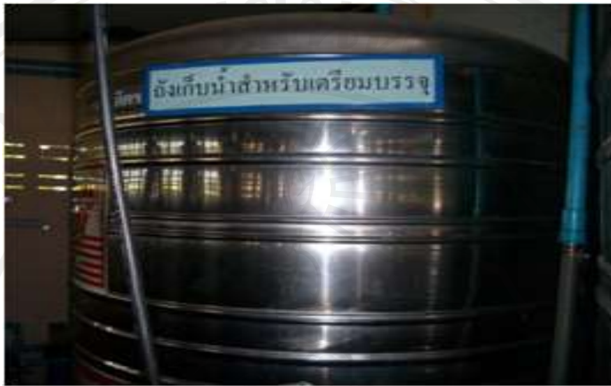
ภาพที่ 5 แสดงถังเก็บน้ำสำหรับเตรียมบรรจุ
