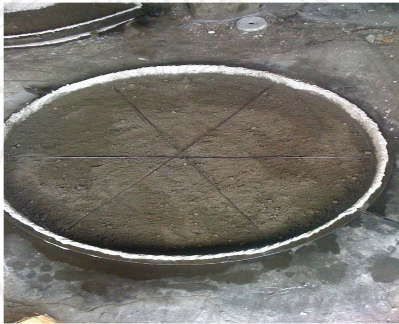
ภาพที่ 26 การเทพูนผสมทรายแห้ง และการวางเหล็กเส้น
