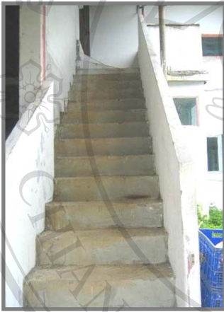
ภาพที่ 4.13 คิวบันไดทางขึ้น อาคารผลิตขรุขระ
