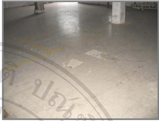
4.12 พื้นกระเบื้องยางที่ห้องเก็บสินค้าชำรุด
