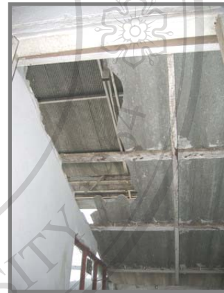
ภาพที่ 4.20 ฝ้าห้องควบคุมระบบไฟฟ้าชำรุด
