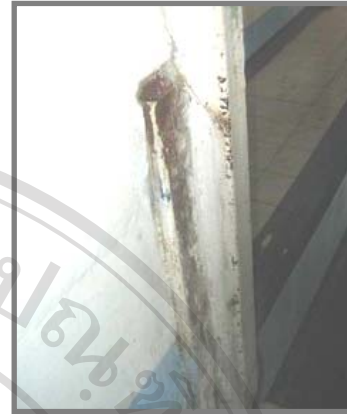
ภาพที่ 4.24 ปลายท่อเหล็กที่ห้องผลิต 1 ไม่ได้อุดรู
