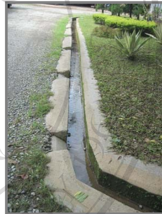
ภาพที่ 4.8 ลักษณะทางระบายน้ำรอบโรงงาน ไม่ลาดเอียง และมีน้ำขัง
