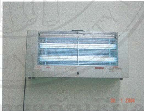
ภาพที่ 4.4 อุปกรณ์ดักแมลงภายในโรงงาน
