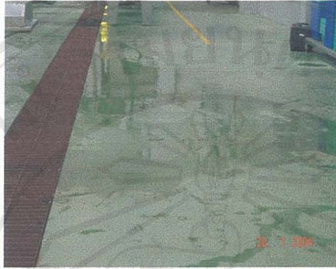
ภาพที่ 4.5 พื้นภายในอาคารการผลิต ไม่ลาดเอียงทำให้เกิดน้ำขัง
