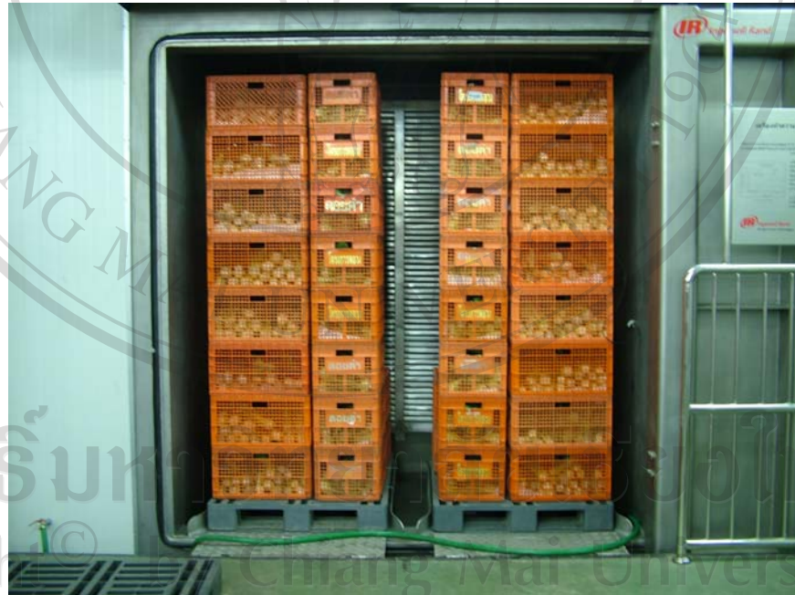
ภาพที่ 3.9 ลักษณะการจัดเรียงตะกร้าภายในห้องลดอุณหภูมิระบบสุญญากาศ
