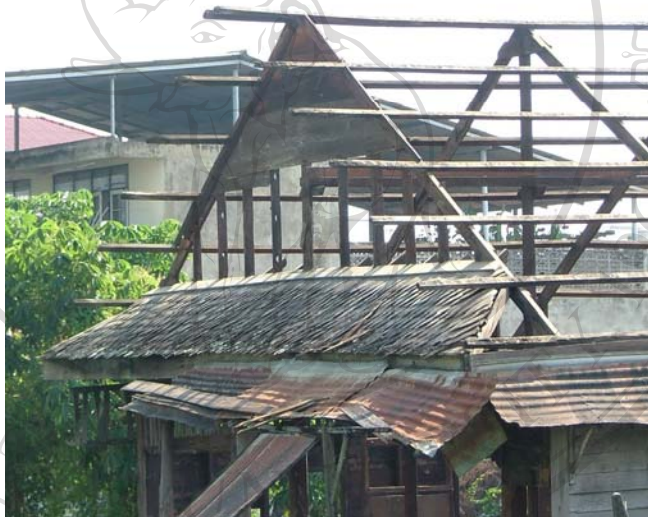
ภาพ 4.8 โครงสร้างหลังคาเรือนไม้ร้านค้าย่านประตูชัย
