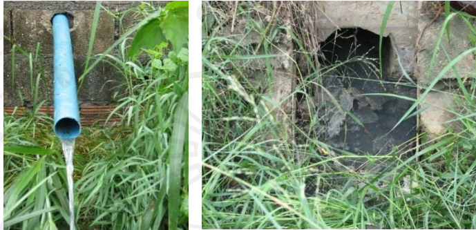
ภาพที่ 17-18 ท่อน้ำทิ้ง จากหมู่บ้านจัดสรร ออกมาจากหลังหมู่บ้านจัดสรร
