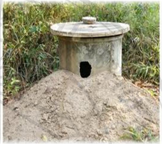
ภาพ 15 ท่อน้ำทิ้งจากครัวเรือน ในเขตเทศบาล ตำบลสันทรายหลวง ต้องห่างจากแหล่งน้ำ ธรรมชาติ 10 เมตร ขึ้นไป
