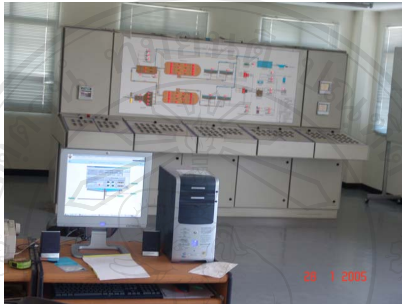
ภาพที่ 4.20 แสดงห้องควบคุมระบบบำบัดน้ำเสียแบบ Oxidation Ditch ของเทศบาลเมืองกาญจนบุรี
