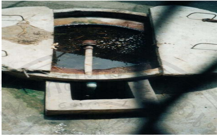
การต่อท่อก๊าซจากบ่อหมักไปใช้ในบ้านเรือน
