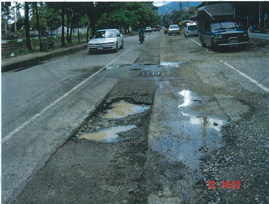
ภาพที่ 4 สภาพถนนที่ชำรุดเกิดจากการฝังกลบของผู้รับเหมาที่ไม่ได้มาตรฐาน
