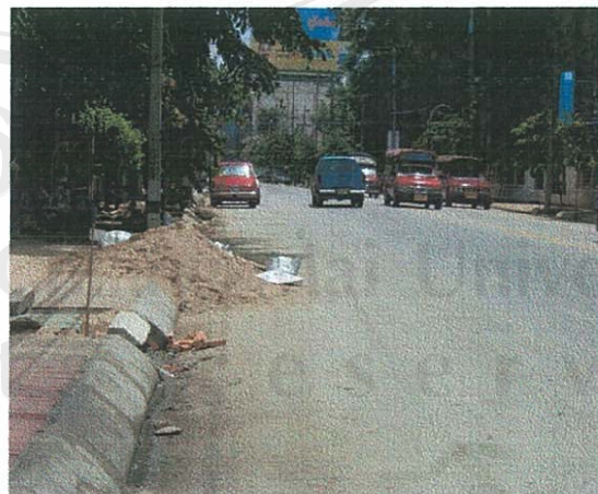
วางวัสดุก่อสร้างเร็วราด เมื่อรถผ่านไปมาก็เกิดฝุ่น
