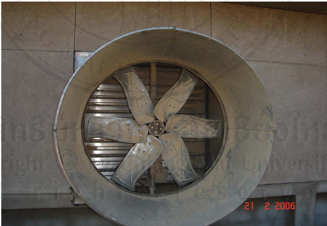
รูปที่ 3.4 พัดลมที่เป็นอุปกรณ์ในการดูดความเย็นเข้ามาในโรงเรียน
