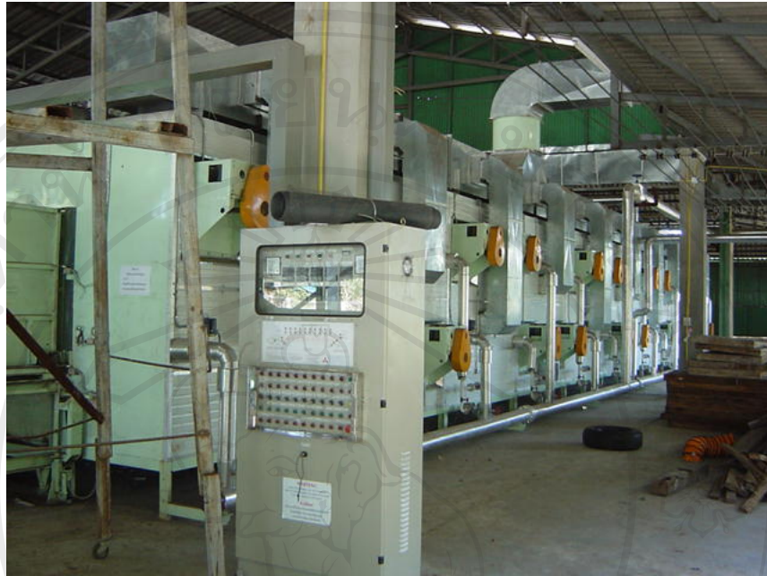
ภาพที่ 8 ตู้ระบบควบคุมอุณหภูมิของแต่ละเตา
