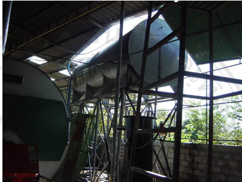
ภาพที่ 10 ถังสำหรับเก็บน้ำมันเตาขนาดบรรจุ 12,000 ลิตร
