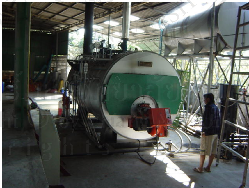
ภาพที่ 9 ถังสำหรับต้มน้ำเพื่อทำไอน้ำ
