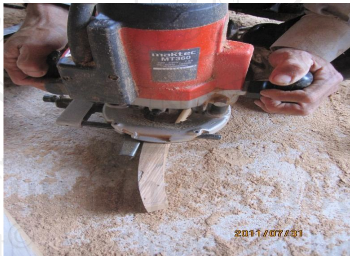
ภาพที่ 37 เจาะรูสำหรับประกอบโครงสร้างโดยใช้เร้าเตอร์
